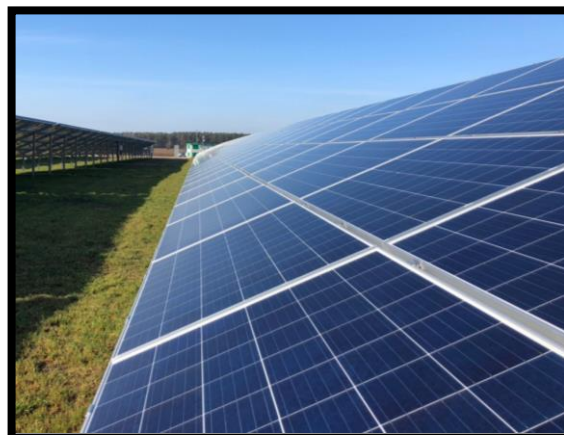
Zdjęcie 2 Polikrystaliczne panele fotowoltaiczne
