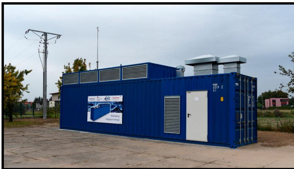
Zdjęcie 6 Przykład magazynu energii
